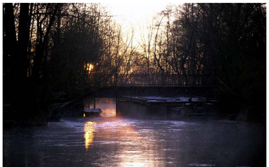
Schwimmendes Arbeitsfloß an der Saukopfbücke. Praktisch entlang des gesamten Gewässerlaufes fanden Arbeiten statt
